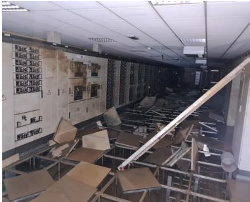
Châssis TGBT après inondations
