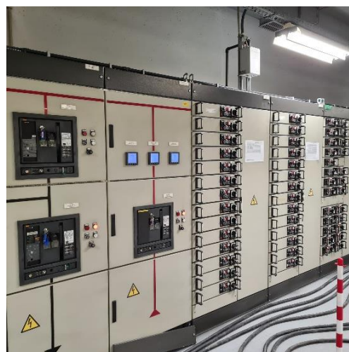
TGBT avant inondation
